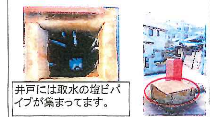
井戸には取水の塩ビパイプが集まっています。
